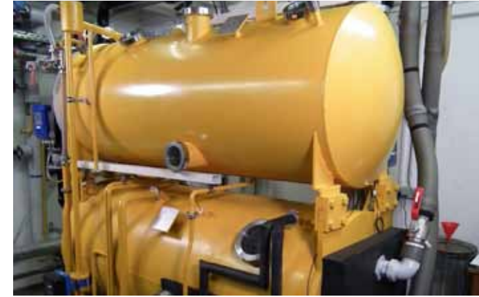
Abbildung 47: Absorptionskälteanlage AKA „Hummel“ für niedrige Temperaturen
